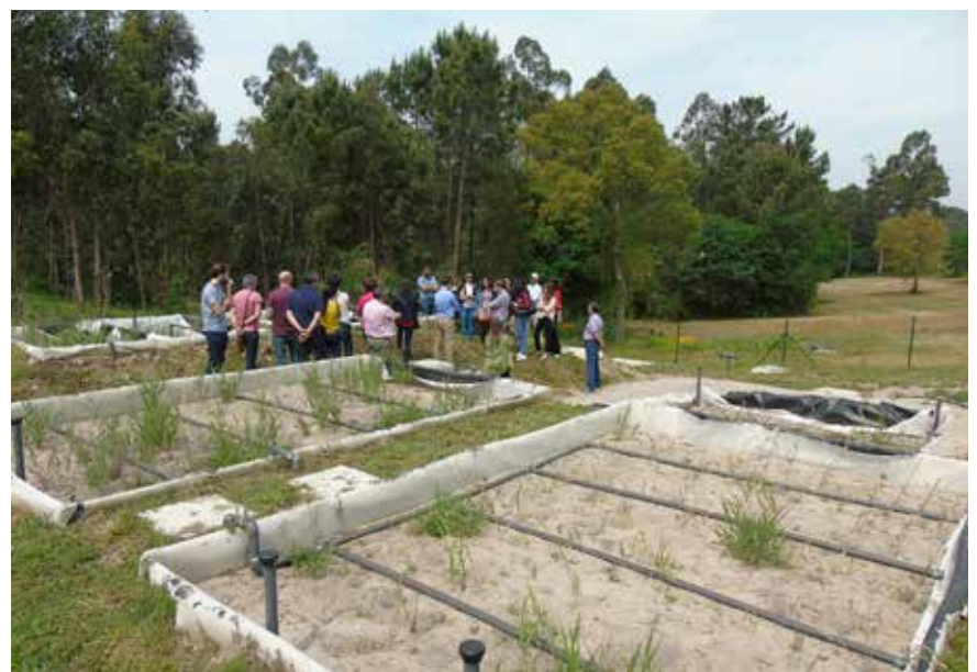
Visita a la planta WETWINE por parte de los asistentes. En primer plano humedales construidos del tipo subsuperficial verticales.
