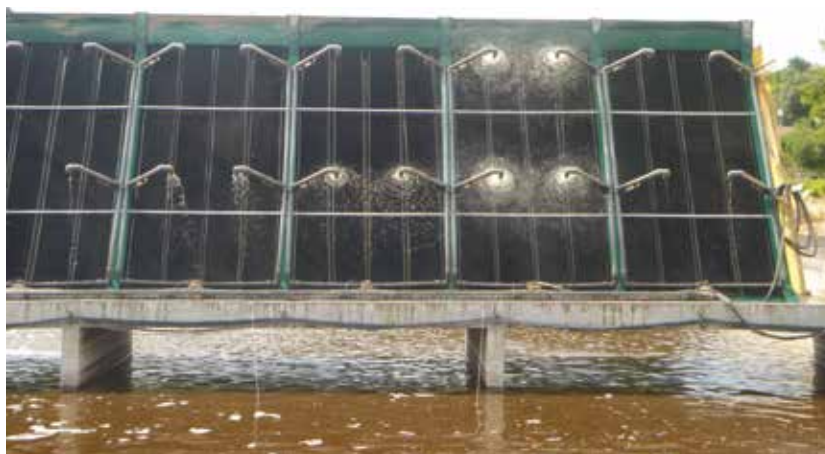
Figura 2. Sistema de tratamiento de efluentes de tipo evaporación favorecida de la bodega Dom Brial situada en Baixas, Francia.
